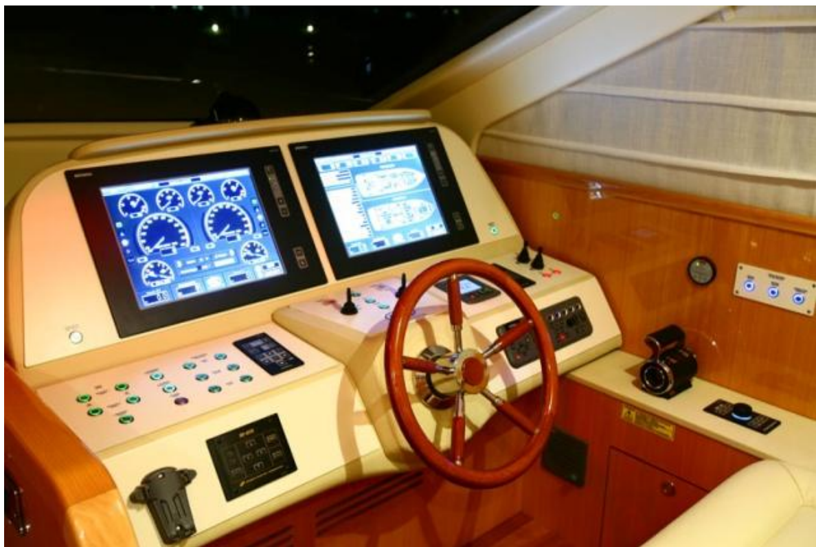
Steuerhaus mit integriertem Alarm, Anzeige und Überwachungssystem Wheelhouse with integrated alarm, monitoring and control system
